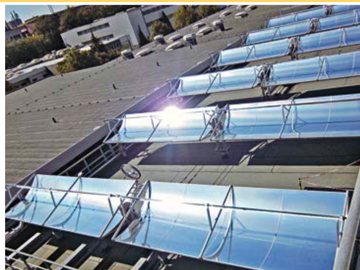
Abb. 19 Eine Parabolrinnenanlage mit sechs mal zwei Parabolrinnenkollektoren. Quelle: Anna Durst, BINE Informationsdienst
