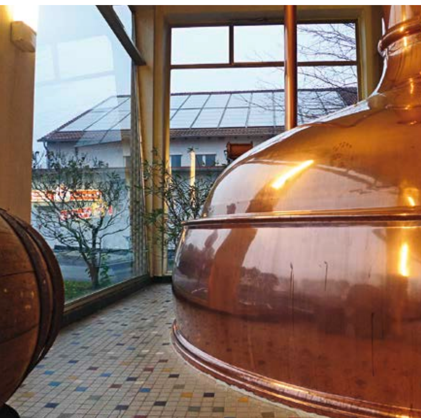
Abb. 3 Die Solarthermieanlage im Hintergrund des Sudhauses der Hütt-Brauerei bei Kassel stellt warmes Wasser für den Brauprozess bereit. Quelle: Universität Kassel
