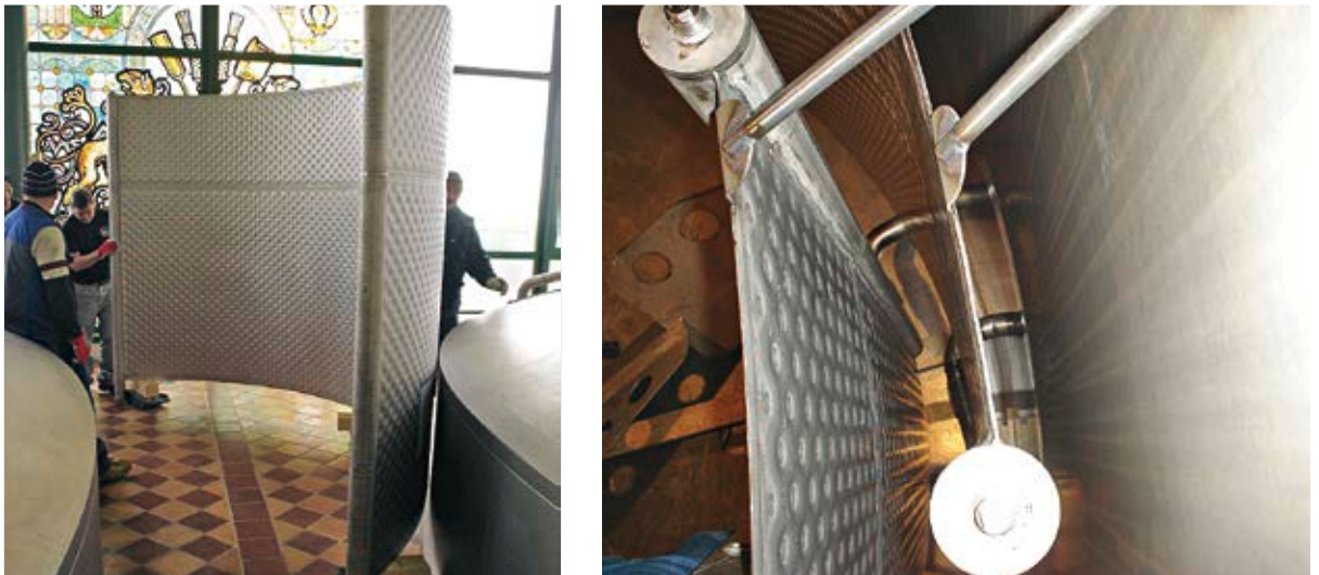
Abb. 8 Installation eines internen Wärmeübertragers in eine Maischepfanne in der Göss Brauerei in Österreich. Quelle: AEE INTEC
